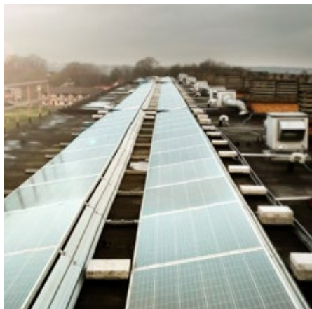
Solpaneler på Holiday Inn Brussels Airport
